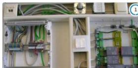
Gebäudesystemtechnik optimieren und erweitern
